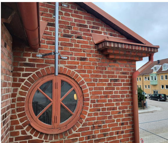
Hörn mot öster markerat med kraftigt listverk. Det runda fönstret ger ljusinsläpp till trappan i foajén.
