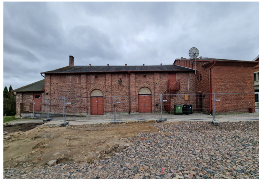
Vy från norr. Byggnaden är indelad i tre tydliga volymer. Mot denna sida finns utrymningsdörrar, personalingång samt ingång till loge i tillbyggnaden.
