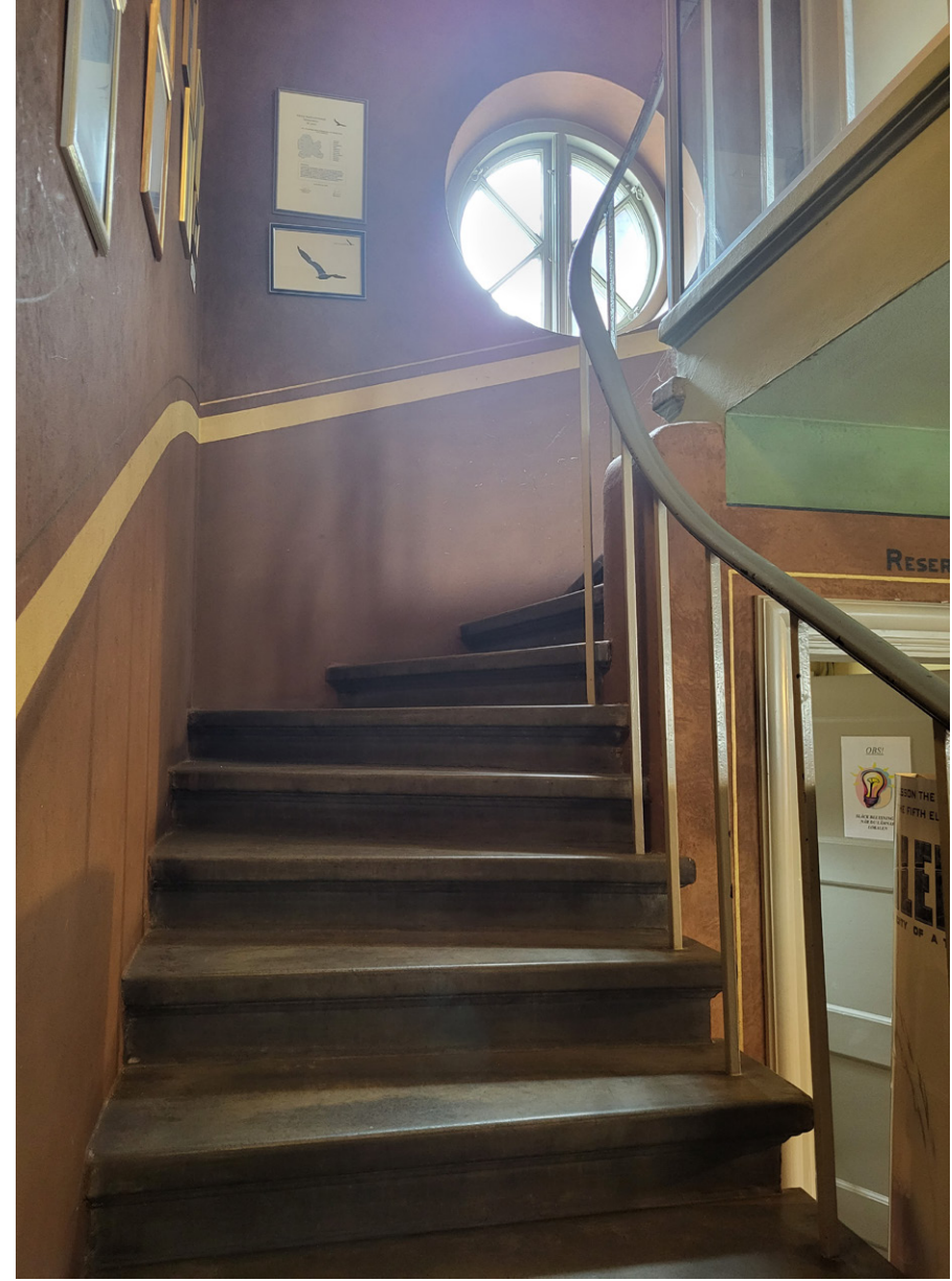
I trappan finns ljusinsläpp från ett runt fönster mot öst. Det övre bjälklaget har en profilerad utskjutande kant. Väggan mot bakre ingången har ett rundat hörn.
