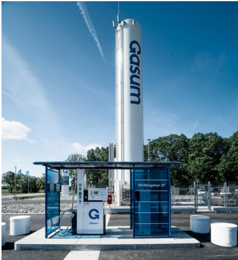
Figur 42 Exempel på lagringsanläggning för flytande metan, i form av publik tankstation lokaliserad i Norrköping. (Gasum.com)
